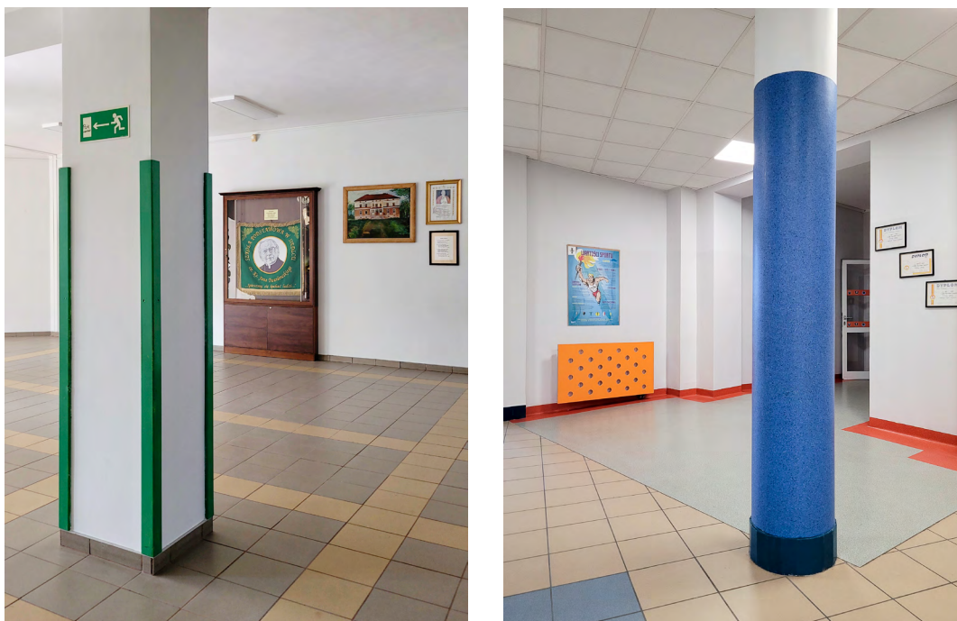
Ilustracja 54. Przykład zabezpieczenia i wyróżnienia elementów konstrukcyjnych budynku, fot. Katarzyna Guratowska
